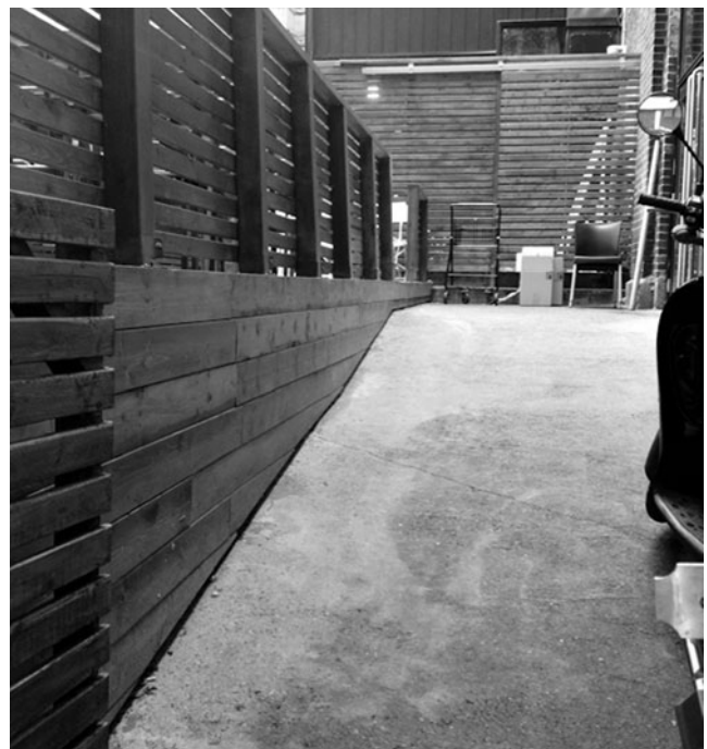
Figure 1: Un seuil au haut d'une rampe d'accessibilité empêche l'accès à une terrasse extérieure
